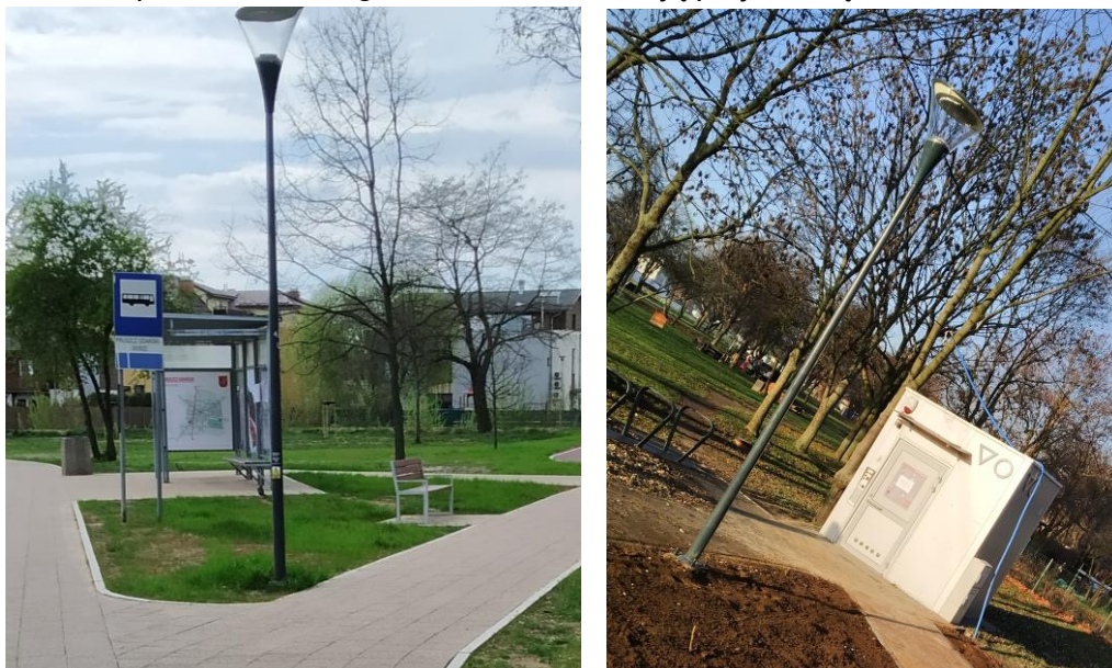
Fot. Przykładowe oprawy oświetleniowe parkowe
