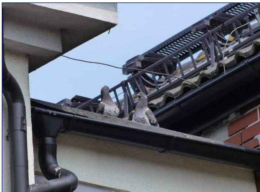
Fot. 13. Gołębie na dachu budynku przy ulicy Wita Stwosza 14
