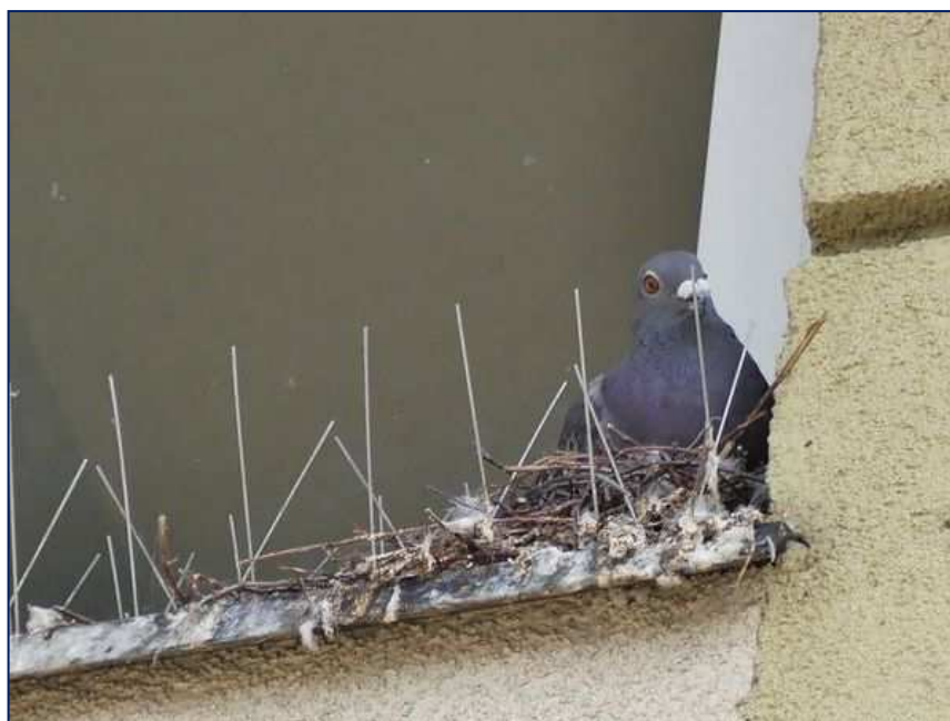
Fot. 22. Gniazdo gołębia na budynku przy ulicy Wojciecha Kossaka 8
