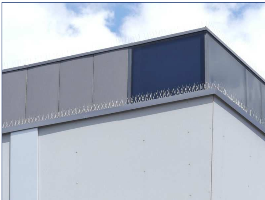
Fot. 1. Zabezpieczenia (kolce) na gzymsie budynku przy ulicy Wita Stwosza 2A
