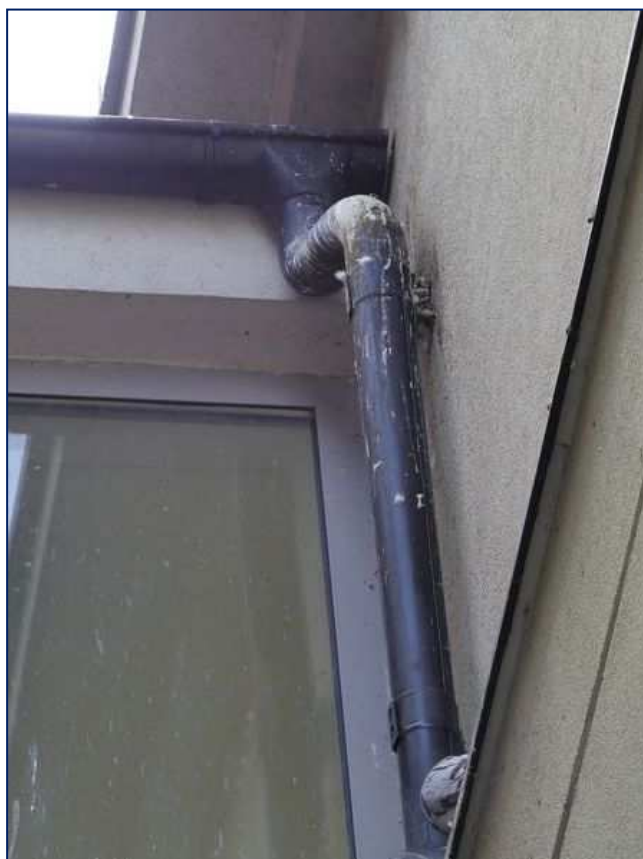
Fot. 14. Ślady odchodów gołębi na rynnie budynku przy ulicy Wita Stwosza 14
