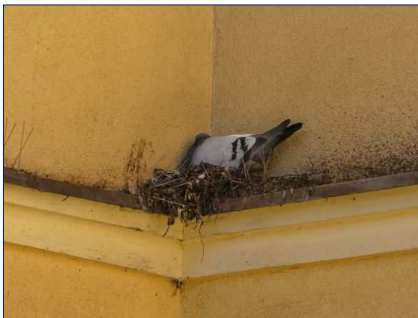
Fot. 28. Gniazdo gołębia na gzymsie budynku przy ulicy Grunwaldzkiej 25
