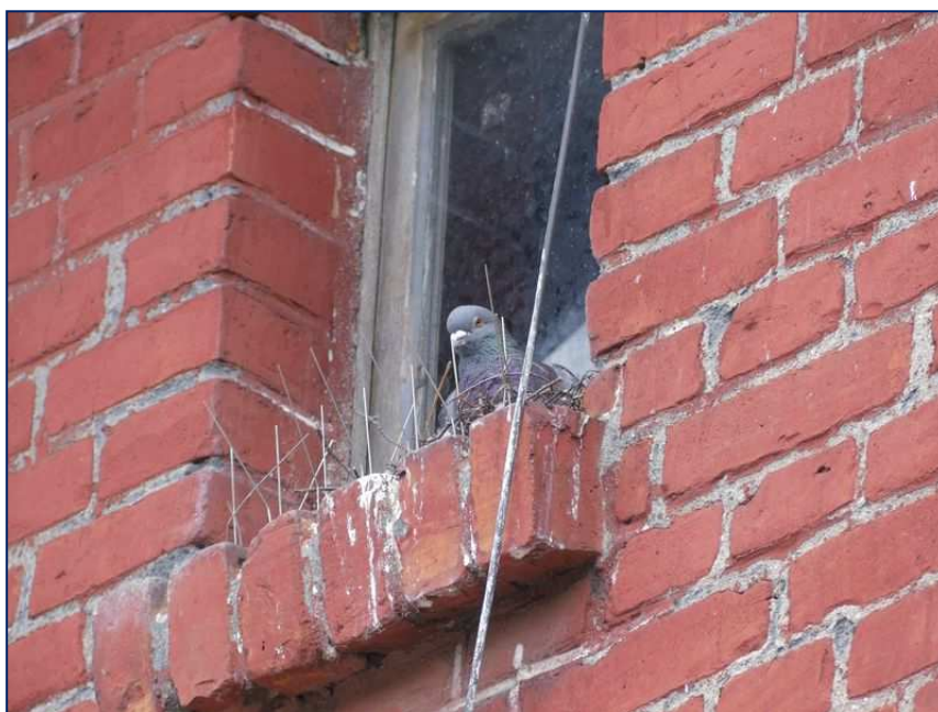
Fot. 6. Gniazdo gołębia na budynku przy ulicy Fryderyka Chopina 18
