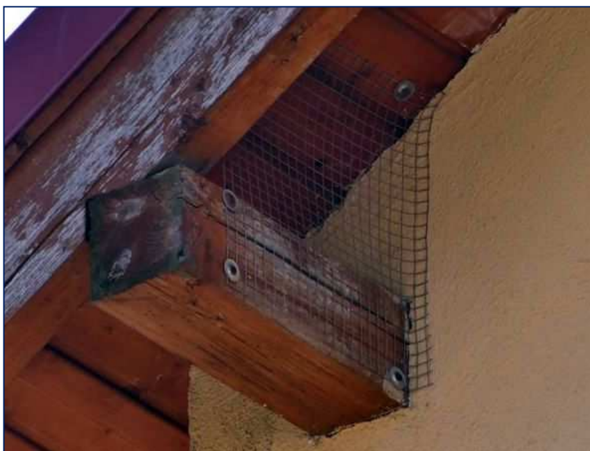
Fot. 25. Zabezpieczenie więźby dachowej przed siadaniem gołębi na budynku przy ulicy Wojciecha Kossaka 1
