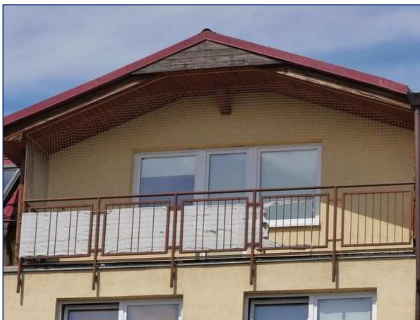
Fot. 19. Źle założona siatka na balkonie budynku przy ulicy Wojciecha Kossaka 6 – liczne luki, umożliwiające dostawanie się gołębi na balkon
