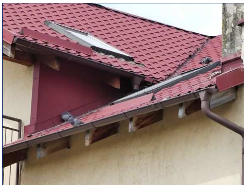
Fot. 16. Gołębie na dachu budynku przy ulicy Wojciecha Kossaka 1
