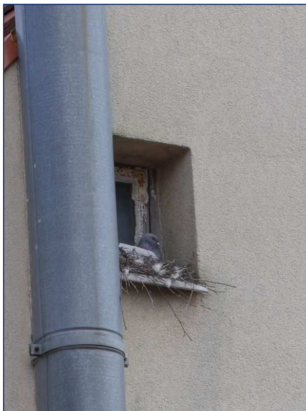
Fot. 7. Gniazdo gołębia na budynku przy ulicy Fryderyka Chopina 16
