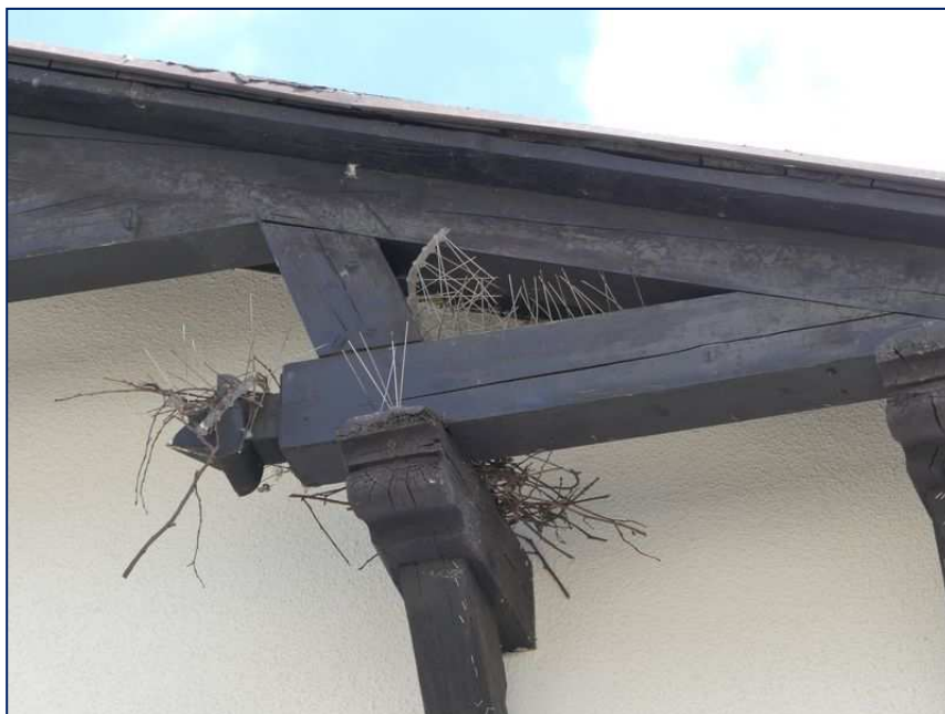
Fot. 2. Zaniedbane zabezpieczenia (kolce) na więźbie dachowej budynku przy ulicy Fryderyka Chopina 24
