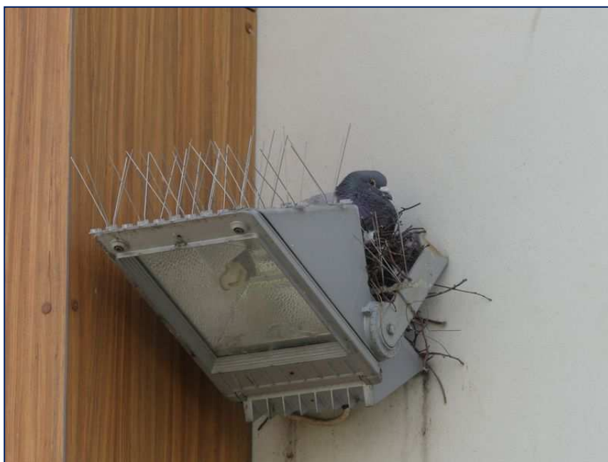
Fot. 5. Gniazdo gołębia na budynku przy ulicy Wita Stwosza 2
