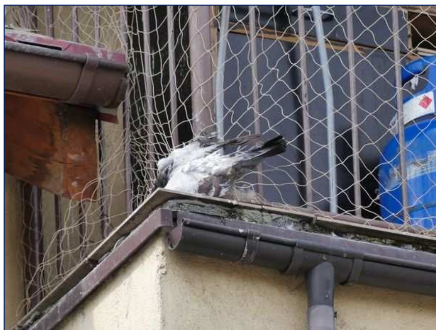
Fot. 18. Źle napięta siatka na balkonie budynku przy ulicy Wojciecha Kossaka 1, która przyczyniła się do śmierci dwóch gołębi
