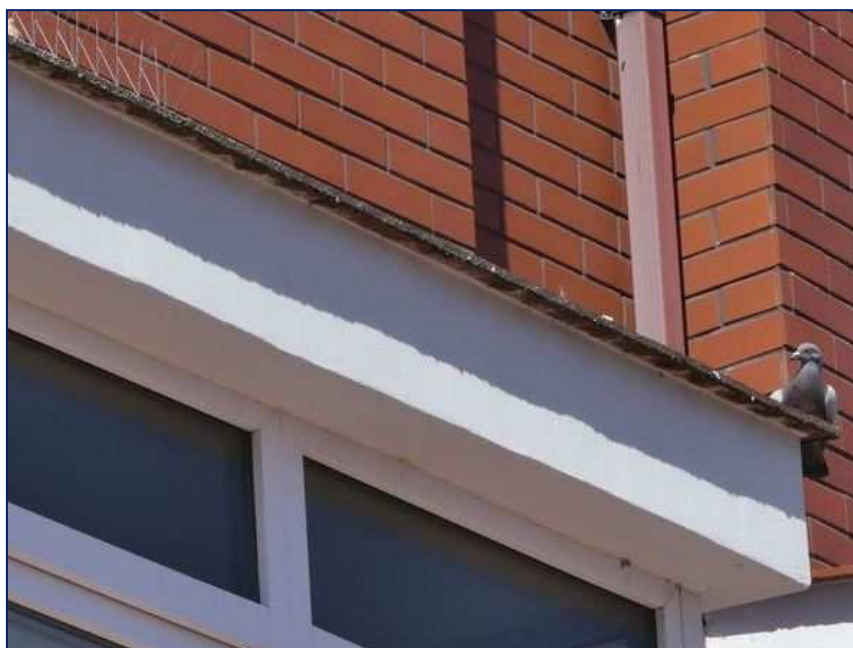
Fot. 30. Zaniedbane zabezpieczenia przed siadaniem gołębi na budynku przy Alei Księdza Józefa Waląga 4
