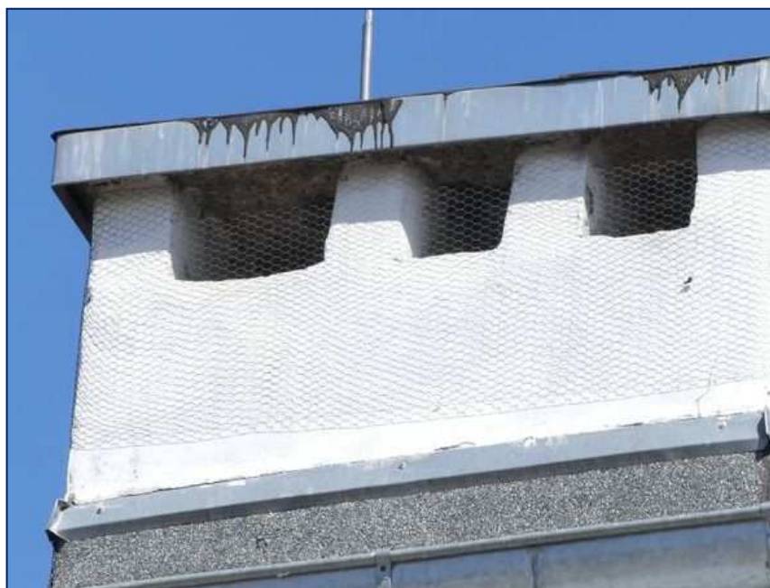
Fot. 27. Zabezpieczenie komina przed wchodzeniem gołębi na budynku przy ulicy Grunwaldzkiej 25
