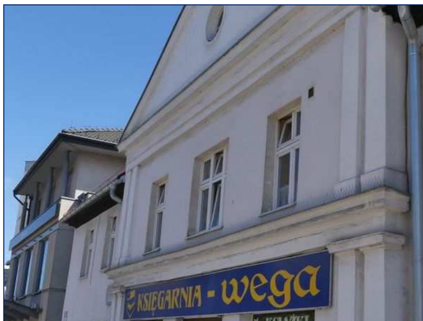
Fot. 29. Prawidłowo założone zabezpieczenia (kolce) przed siadaniem gołębi na zabytkowym budynku przy ulicy Grunwaldzkiej 23
